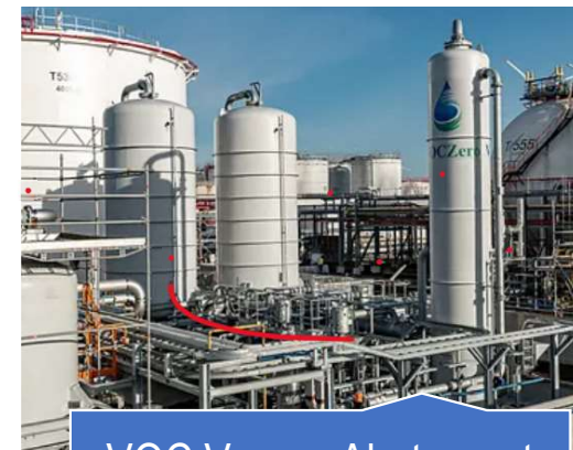
VOC Vapour Abatement Systems
